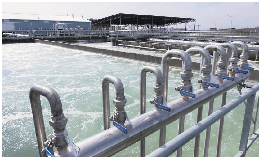
Очистные сооружения около Суаки
